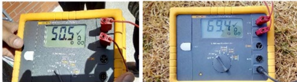
Fig. 11. Valores de resistencia de puesta a tierra del sistema fuera de norma.
