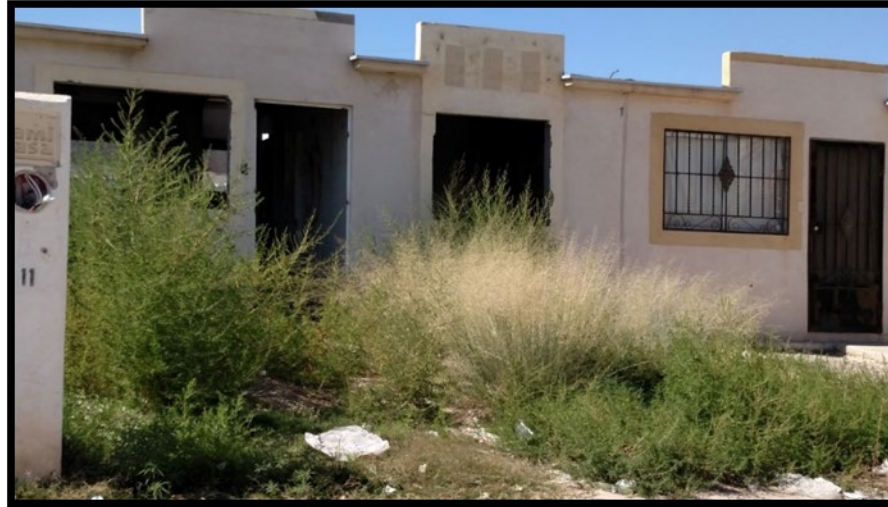
Fig. 5. Vivienda en estado de abandono y deterioro por falta de uso.
